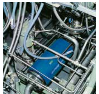
Im Motorraum einer Yacht installiertes KRAL Durchflussmessgerät.
